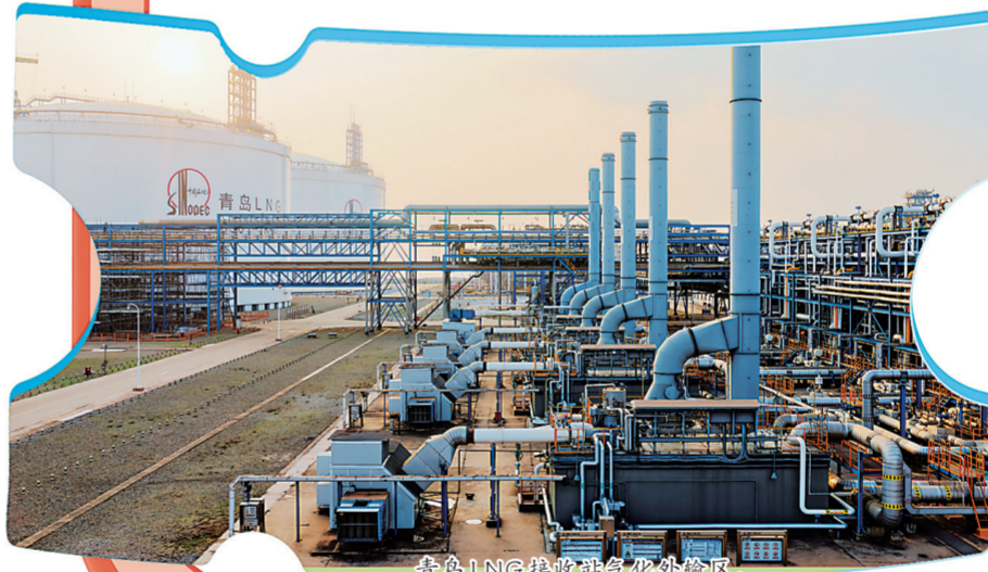
青岛LNG接收站气化外输区。
