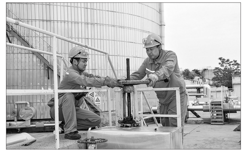
今年以来,沧州炼化持续细化装置工艺管控,严格执行操作规程,加密现场巡检频次,通过精准调控加热炉、分馏塔关键温度参数,规范原料切割流程,有效规避换罐引发的泵抽空风险,保障装置平稳高效运行,稳步提升高端石油焦产品质量与产量。图为近日员工在操作原料换罐。张婷摄
