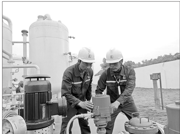
湖北石油常态化抓实油库绿色环保管控,通过技术治污,源头控排,有效降低挥发性有机物排放,实现废气资源回收。图为武汉石油阳逻油库员工巡检油气回收设备。 肖聪聪 摄 陈艺婷文
