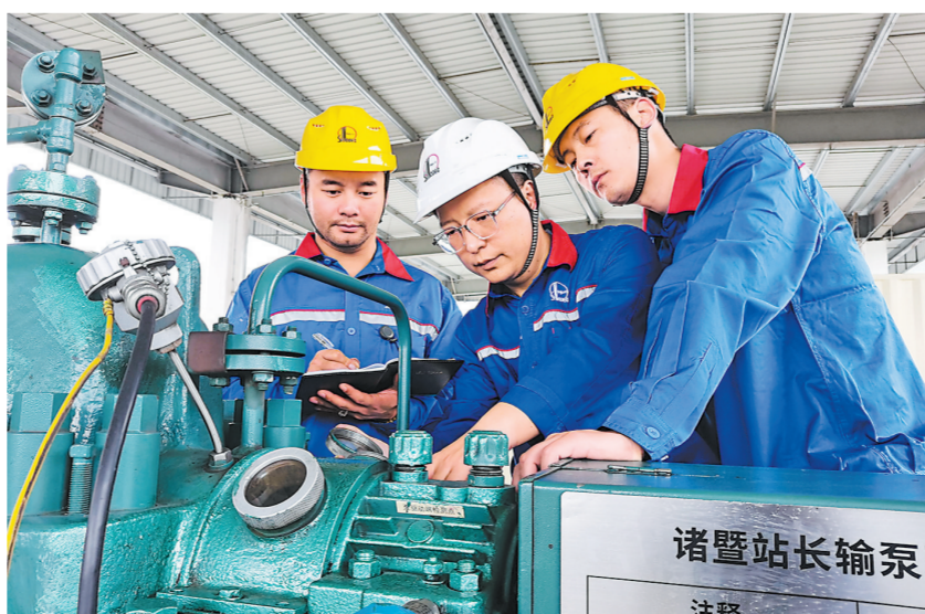
浙江绍兴石油以安全生产责任制为抓手,对照设备运行、现场作业等管理制度要求,全面排查油库、加能站、新能源网点等重点场所风险隐患,筑牢安全生产防线。图为6月22日诸暨油库员工检查长输泵运行状况。车玲 摄 邱丽莉 文
