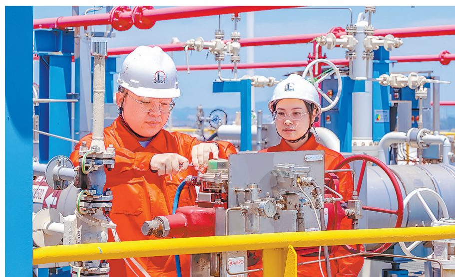
天然气分公司青岛LNG接收站常态化实施预防性检修,加大站内设备检查及维护保养力度,重点校验温度压力传感器、紧急切断阀、可燃气体检测仪等防护设备,从源头消除设备故障风险。图为6月18日员工校验LNG储罐罐顶温度压力传感器。刘晶晶 摄
