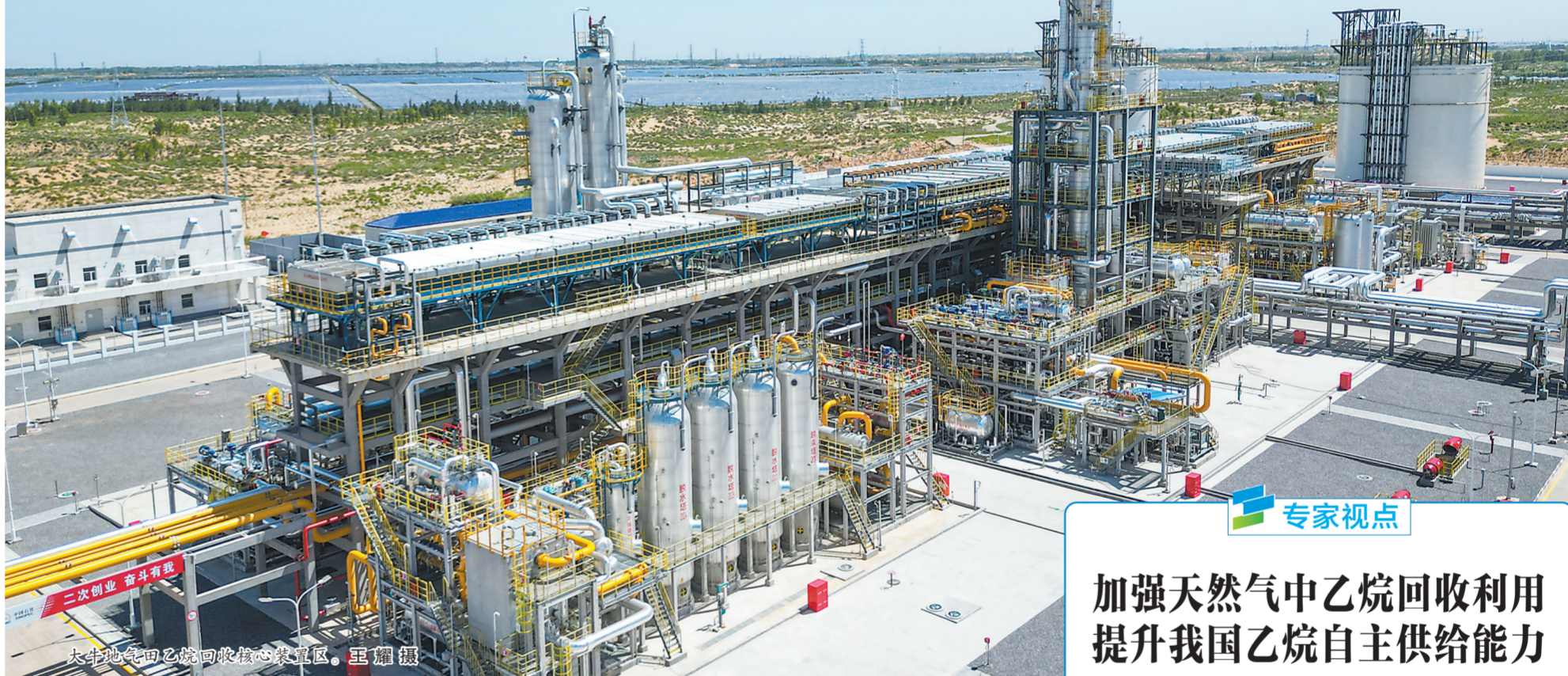
大牛地气田乙烷回收核心装置区。王耀摄
