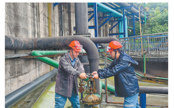
川维化工开展防汛防汛及应急物资专项检查,重点检查雨水沟渠、窨井畅通情况,组织应急演练,增强员工安全意识和应急能力,确保汛期安全生产。图为6月22日员工调节排水阀,提升疏排水量。谢玉霞 摄 杨余文
