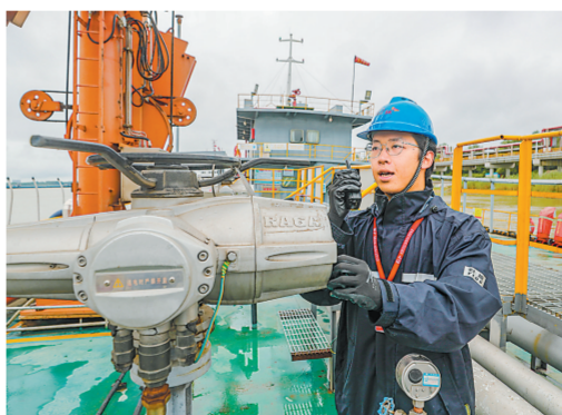
中韩石化全面启动码头防汛应急预案,加密现场巡检频次,抓实汛期安全管控,保障船舶物料装卸平稳。图为6月22日中韩石化储运部炼油码头员工巡检油料调节阀。付松 摄
