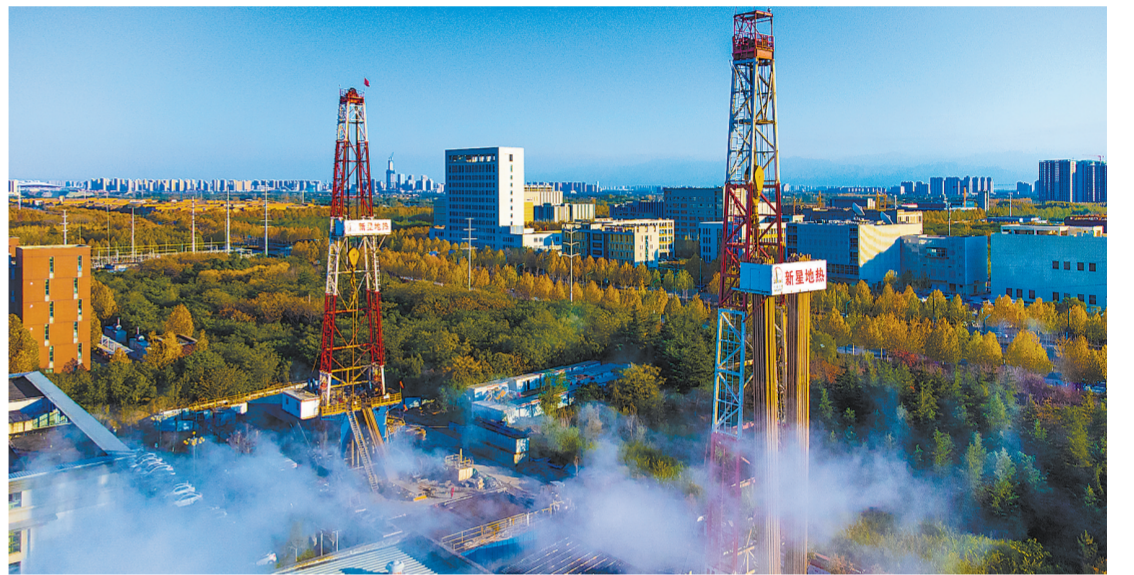
新星新能源公司深耕地热领域,依托科技创新,保障千家万户冬季清洁供暖,为城市降碳减碳添底气。图为新星新能源公司陕西西咸地热替代天然气供暖项目钻井现场。 董继田 摄 曹海峰 文
