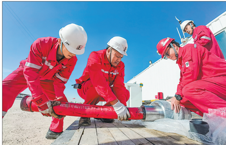
图为西南石油工程公司科威特项目员工在安装设备。孙大杰 摄
