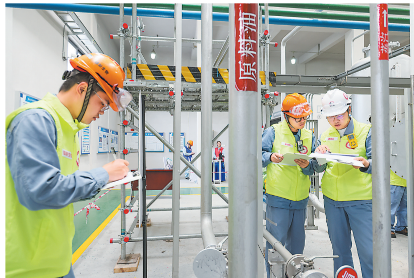
镇海炼化围绕受限空间作业管控要求,开展作业监护人比赛,全面检验安全员和作业监护人履职情况,提升风险隐患排查整治能力。图为5月28日参赛人员在综合实操基地模拟受限空间作业情景,查找安全隐患。何雯 摄
