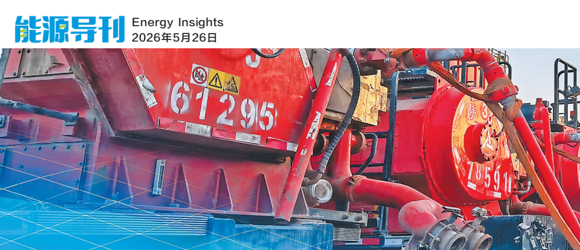
阳城页岩气集气站现场。李俊新 摄
