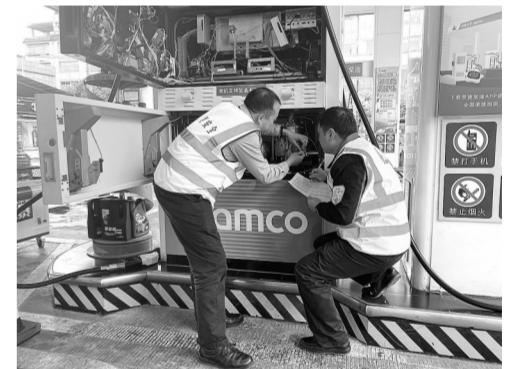
福建龙岩石油上杭城区加能站员工现场核对加油机铅封。
