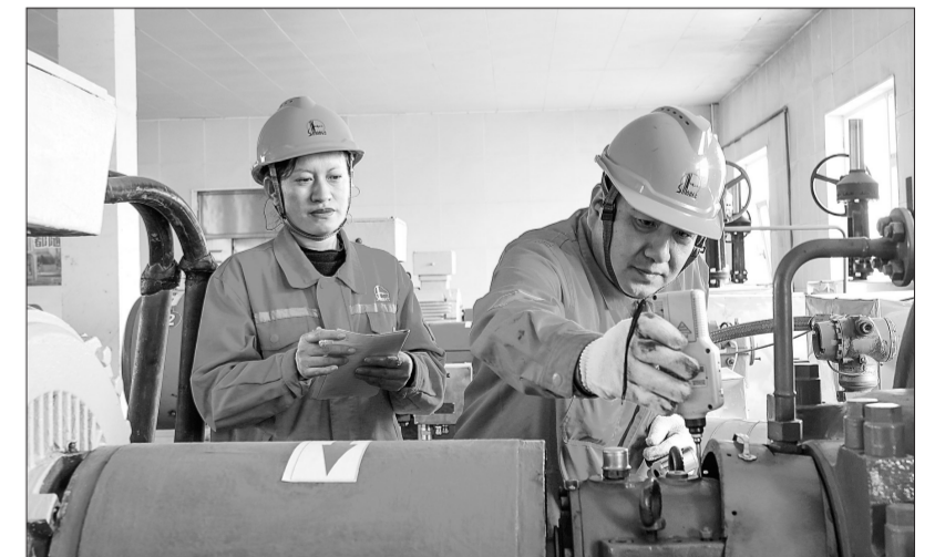
胜利油田海洋采油厂针对近期高温天气,加强设备运行管理,加大现场巡查力度,加密配电箱、泵机房和室外设备巡检频次,重点监测设备生产参数,确保设备安全平稳运行。图为近日员工记录采出水外输泵运行参数。许亮 摄
