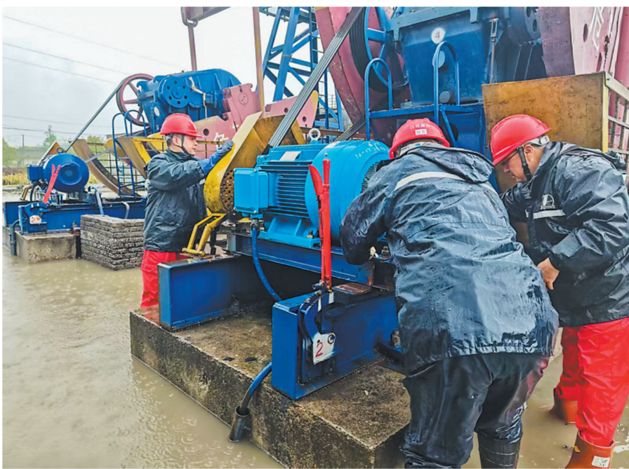
江汉油田迅速启动防汛应急预案,加密现场巡检与远程监测频次,全力开展积水外排、设备抢修、道路疏通等抢险工作,保障生产生活平稳有序。图为5月18日江汉油田荆州采油厂员工更换抽油机皮带。 寇涛 摄 宋国梁 文
