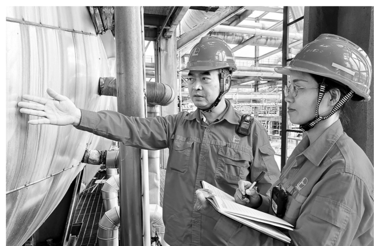
5月8日,中原油田普光分公司天然气净化厂天然气净化研究所运行员工在第五联合装置现场,确定硫冷凝器声发射检测探头位置。孙莞竹摄
