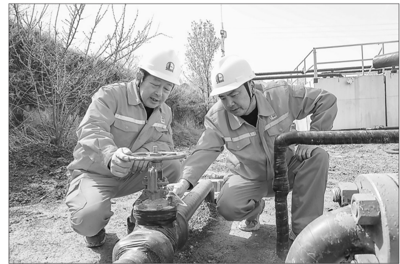
今年以来,华北油气分公司采油一厂针对管线易凝堵、处置成本高、劳动强度大等问题,开展工艺改造提升,实现远程智能管控,有效降低生产成本。图为4月30日员工检查新更换的管线阀门。
