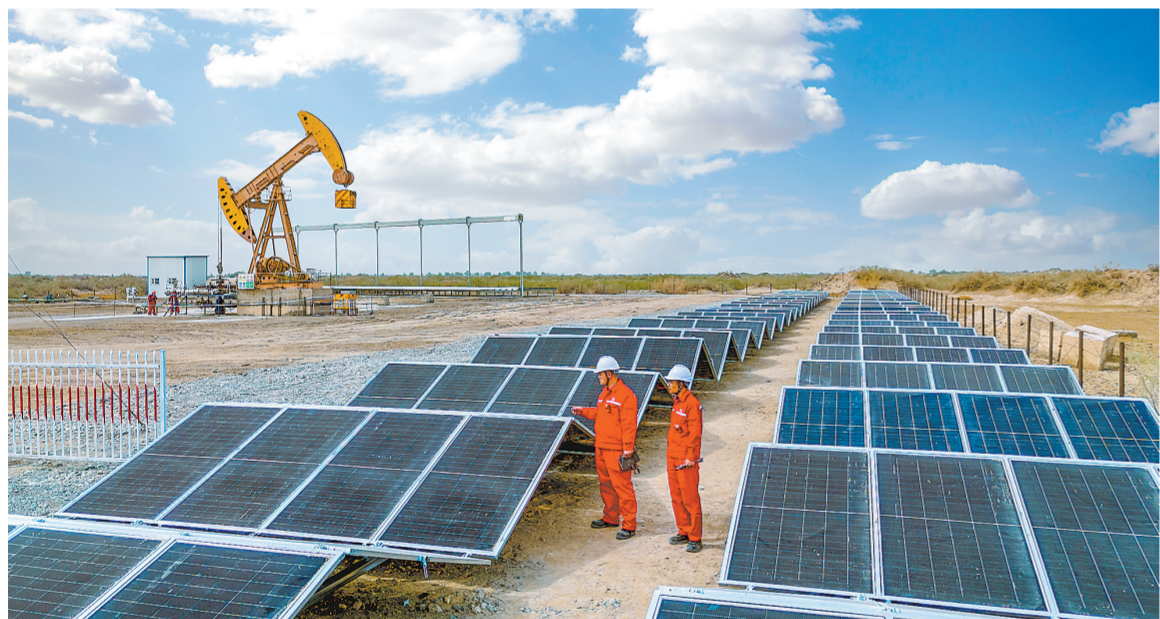
4月30日,西北油田首个偏远单井“光储柴”多能互补微电网在AT22井顺利投运,有效破解偏远井场供电难题。该项目实现井场绿电100%自给,持续降低用电成本。图为5月4日塔河供电管理部员工巡检AT22井场光伏板。崔洪武 摄 张磊文
