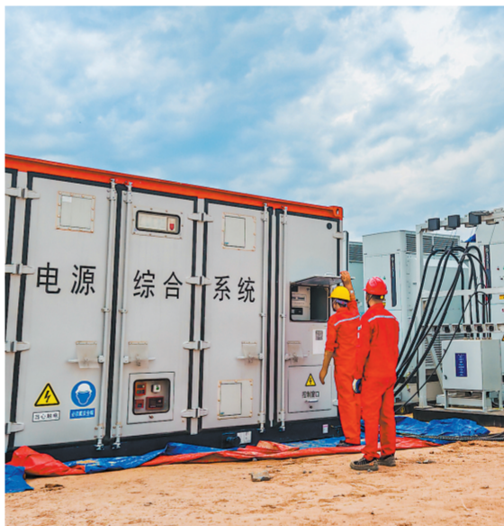
近日,华东油气分公司在位于山西的延川南煤层气田W37平台首次应用“燃气发电+储能系统+电动压裂泵”新型供电模式,实现用电低谷储能、高峰释能,在提升煤层气井储层改造效率的同时,降低用电成本、减少碳排放。图为5月2日员工检查储能系统运行情况。沈志军 摄 张道宏 张波文
