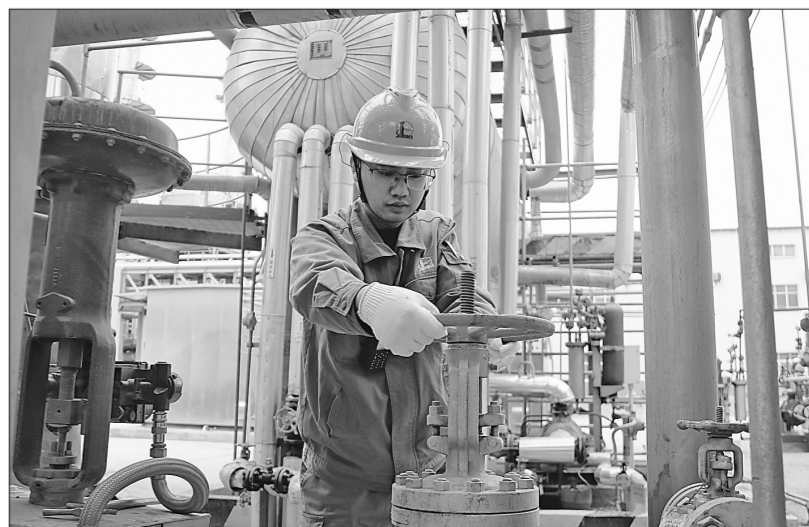
4月12日,塔河炼化航煤装置检修后一次开工成功,顺利产出合格产品,有力保障高附加值航煤产品稳定供应。图为航煤装置员工在开工过程中精心操作。 赵美争 摄
