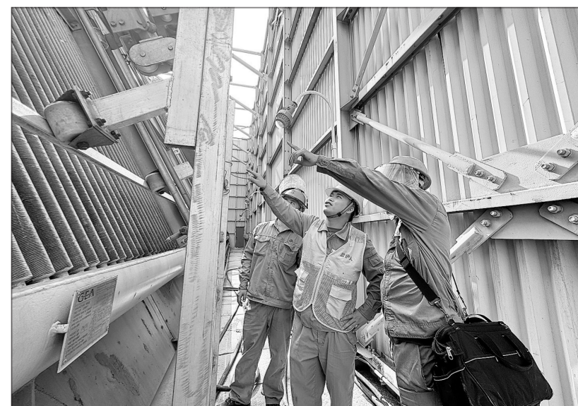
随着气温升高,海南炼化芳烃部对1号芳烃异构化压缩机空冷器及时开展清洗作业,有效清除管束积灰。清洗后,蒸汽消耗量每小时减少0.5吨,实现节能增效。图为4月6日芳烃部员工现场检查空冷器运行情况。吴洋 摄 邱元广 文
