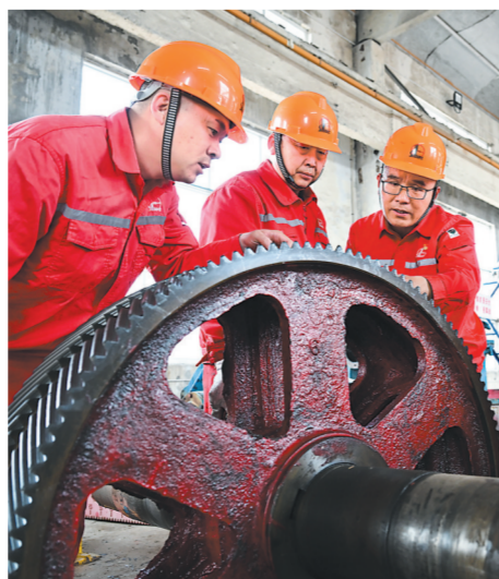
胜利油田员工对注水泵进行能效提升治理。 朱克民 摄
