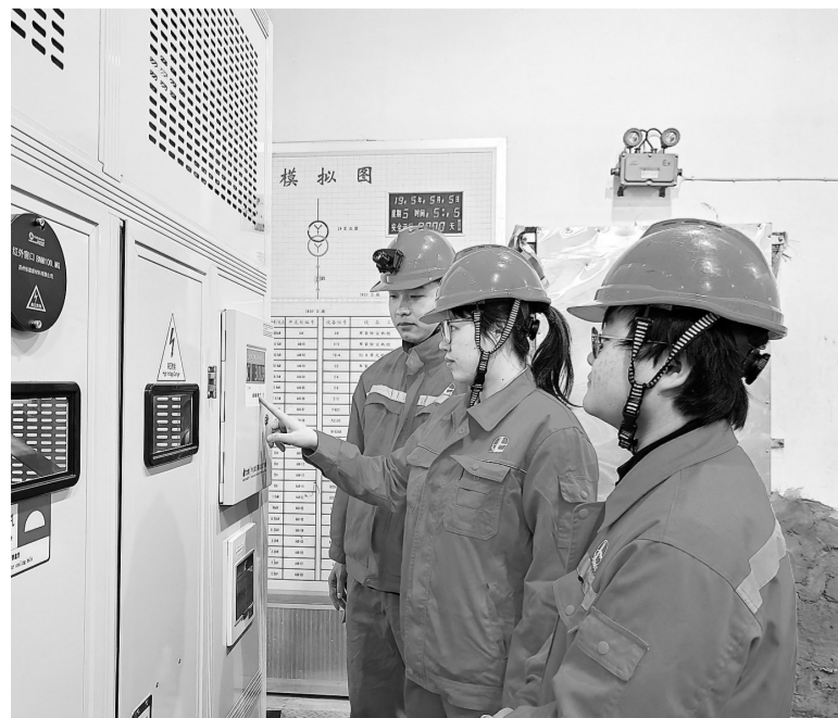
雷雨季节来临,安庆石化密切关注电气设备安全运行,针对新投用变压器加密巡检频次,每2小时开展一次现场检查,依托主控制屏实时监控设备运行状态及三相电压平衡情况,全力保障雷雨天气下电力系统安全稳定运行。图为3月26日,员工查看新变压器运行参数。
