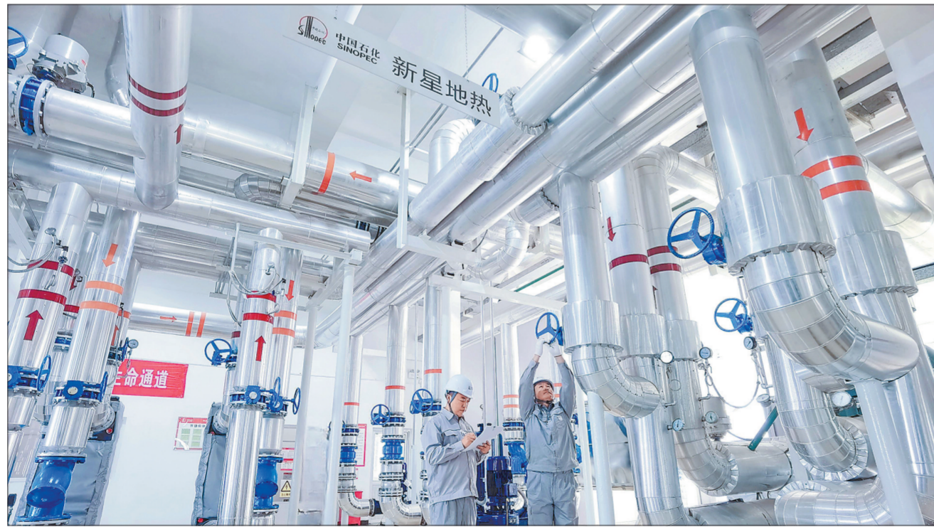
图为新星公司员工在雄安新区地热供暖站巡检设备。
