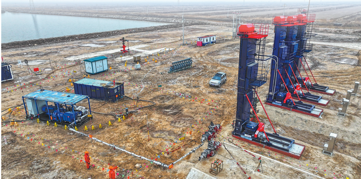
3月10日,胜利油田河口采油厂顺利推进义252-斜13井压驱作业。今年以来,该厂累计实施压驱井28口,注水23.2万立方米,增油1218吨。 吴木水 丁洁 摄影报道
