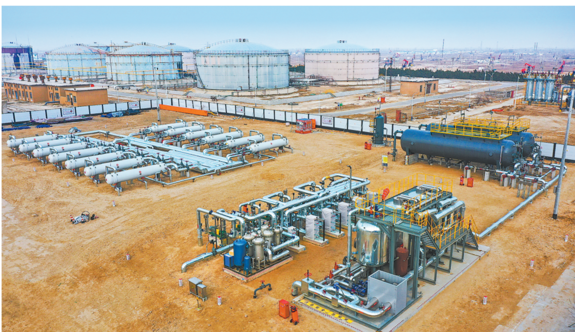
在胜利油田孤东采油厂东一联合站区域供热中心换热站,源源不断的地热能代替传统燃气供热。
