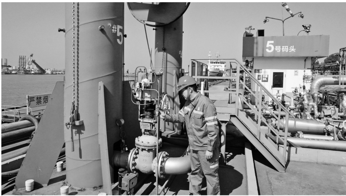
春节期间,高桥石化强化生产装置平稳运行管控,依托数字化管理平台动态跟踪报警处置,加密巡检与现场检查,全力保障春节假期油品市场稳定供应。图为2月20日员工检查黄浦江码头设备运行情况。徐峥辉摄
