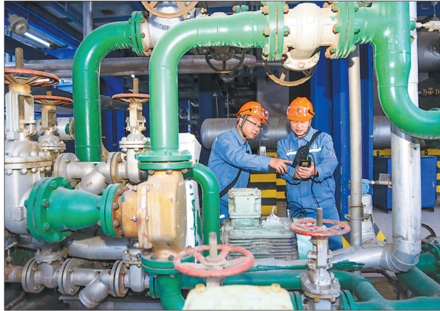
春节期间,齐鲁石化一线干部员工坚守岗位,开展巡检提质工作,做好运行机泵温度、振动等数据采集,确保各装置平稳运行。图为2月21日正月初五,齐鲁石化运维中心炼油电气车间员工采集循环水冷却泵振动数据。 李建强 摄
