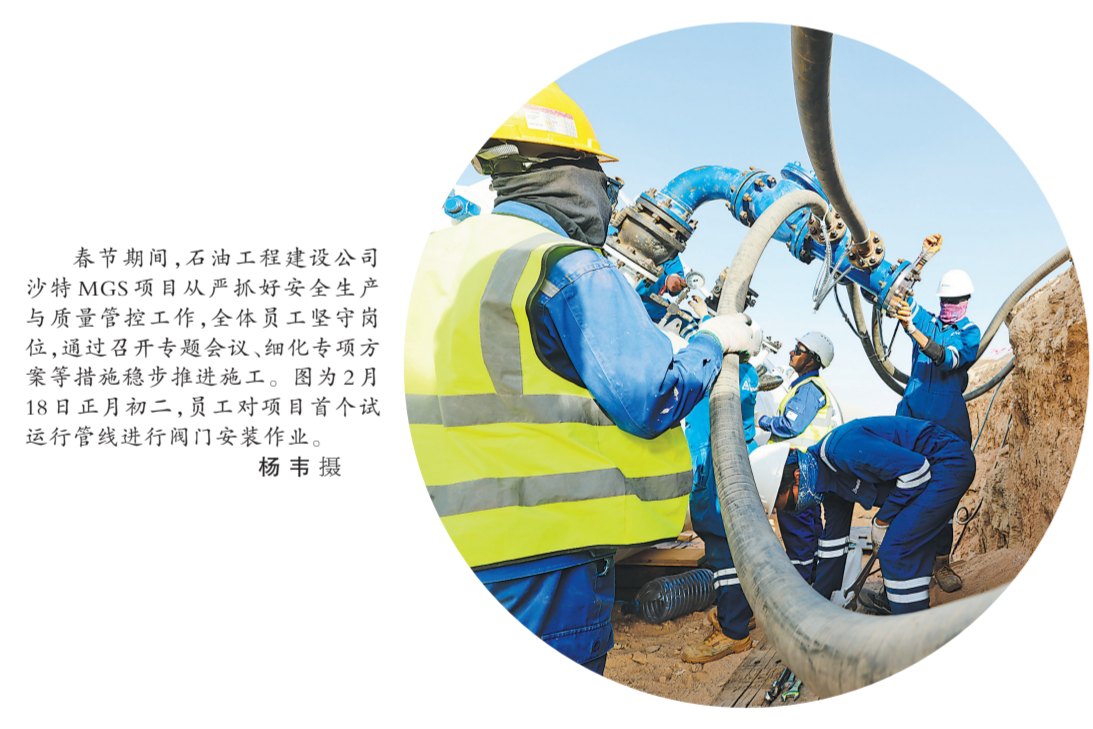
春节期间，石油工程建设公司沙特MCS项目从产好安全生产与质量管控工作，在保员工安全岗位上，通过召开专题会议、细化专项方案等措施稳步推进施工。图为2月18日正月初二，员工对项目首个试运行管线下井阀门安装作业。
