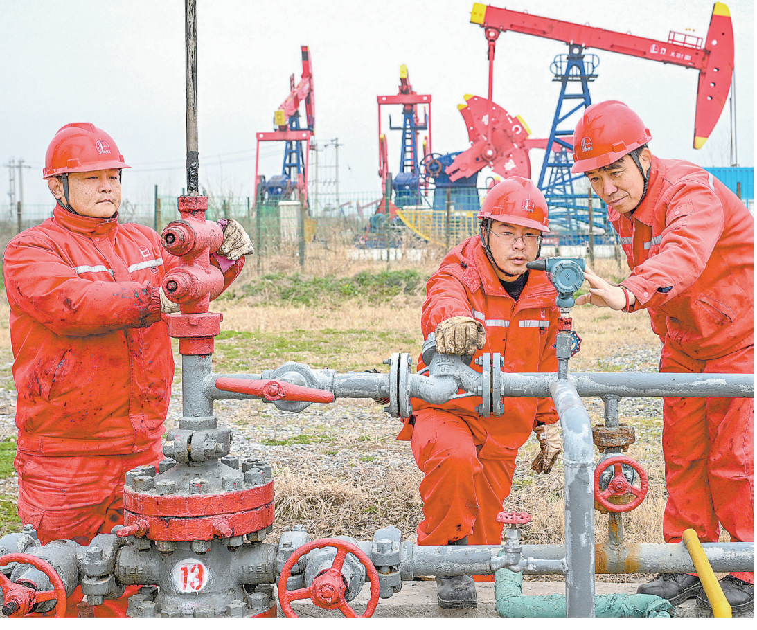
春节期间，江汉油田为确保油气田生产平稳运行，全方位落实安全环保措施，采用“无人机+人工”联合巡检模式，加强对新井、措施井、压裂影响井管控，确保油气田生产平稳与生态安全。图为2月16日除夕，江汉采油厂员工在资203-4井区查看油井运行情况。
