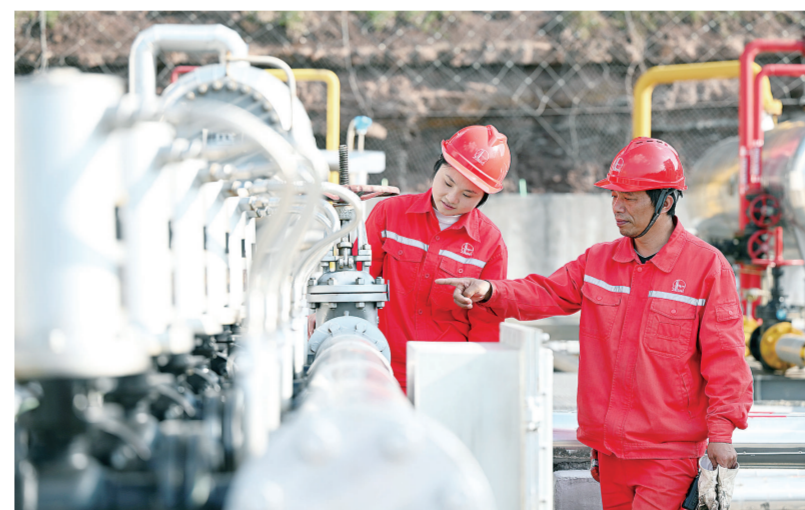
江汉油田泰页1井场员工正在巡检设备。李占军摄
