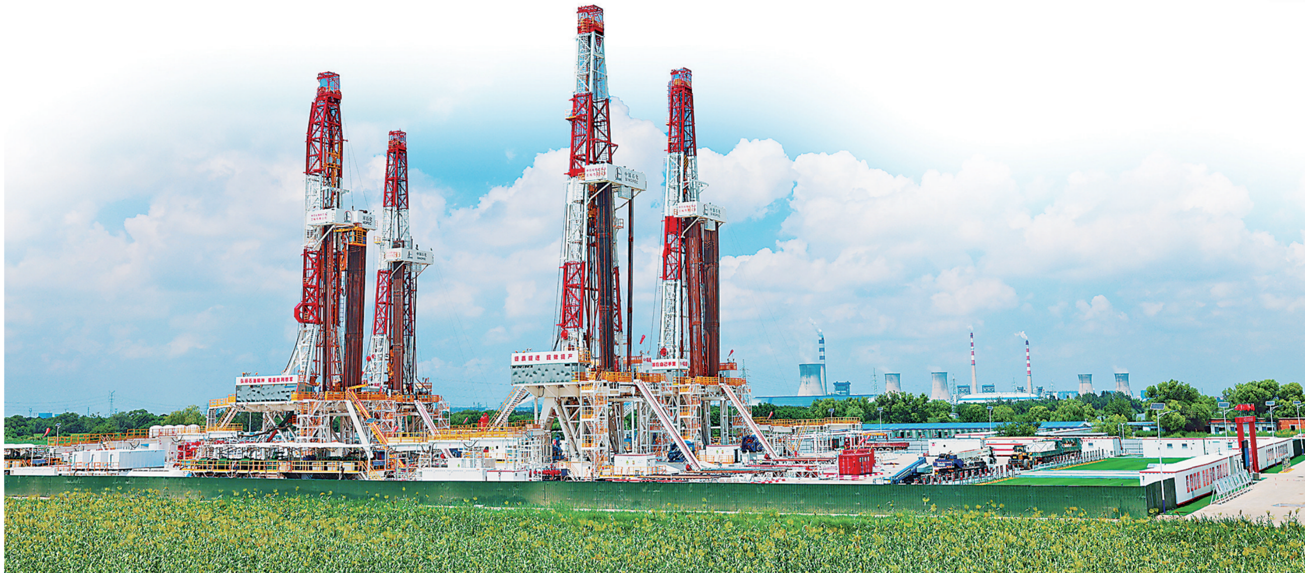
胜利石油工程公司在国家页岩油示范区牛页一区试验井组进行钻井施工。
