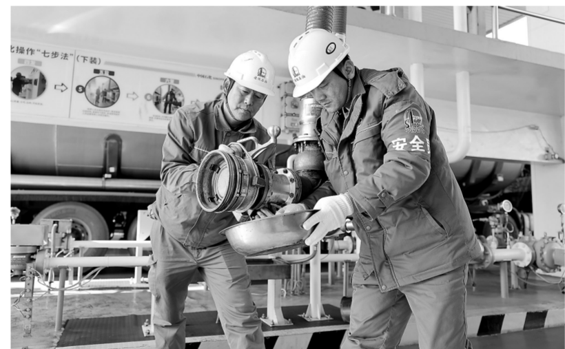
安徽合肥石油油库员工打开铜制针型阀进行鹤管泄压作业。
