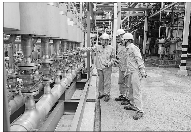
扬子石化烯烃厂乙二醇车间聚焦装置节能降耗目标,通过降低反应器排污量、优化反应器进料量等一系列针对性措施,有效提升装置能源利用效率,能耗优化成效显著。图为员工检查装置运行情况。陶炎 摄于斌 周生文
