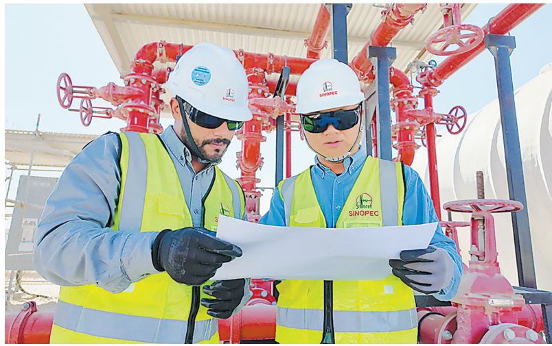
图为沙特籍员工米歇尔(左)与师傅叶勇现场讨论应急演练方案。 郑思远 摄
