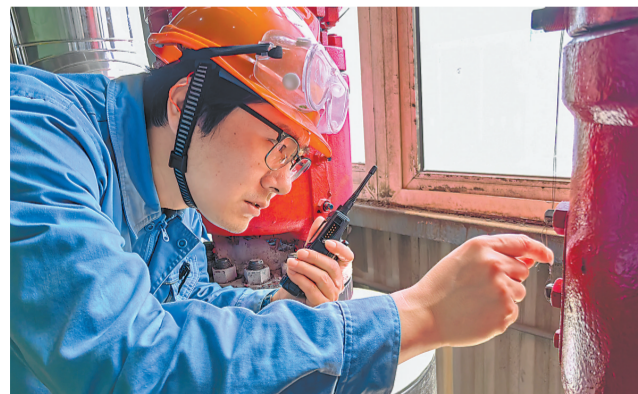
图为11月24日镇海炼化员工现场检查高温蒸汽减温减压设备运行状况。姚尧艳 摄 何雯文
