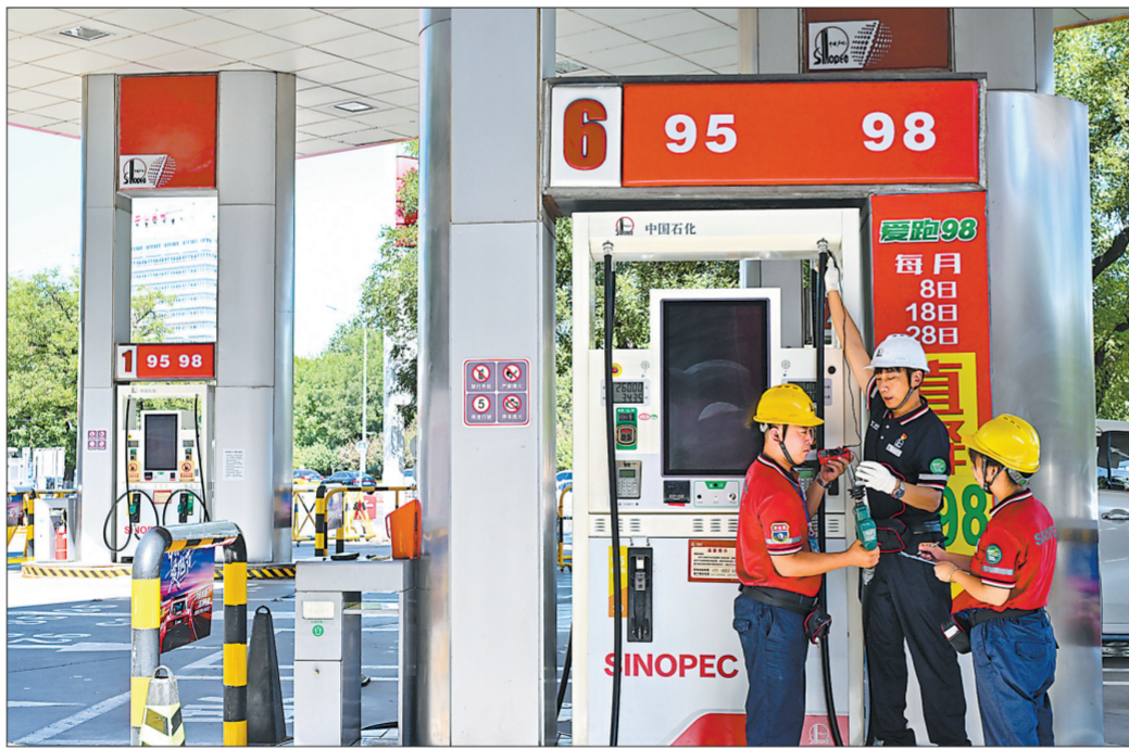
9月1日,北京石油崇文门加能站员工检查设备安全运行情况。
