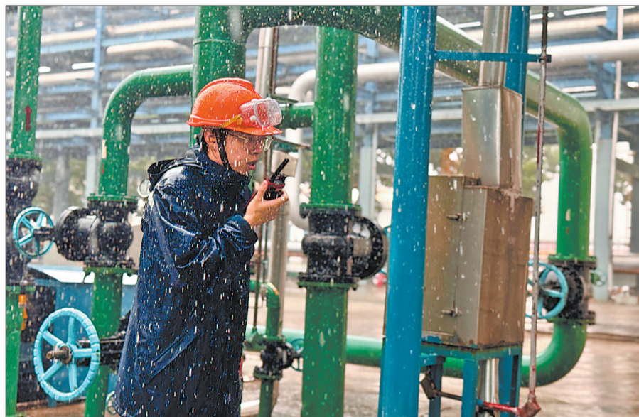
镇海炼化对照台风检查清单,加大巡检力度,重点排查关键设备、排水系统等,确保防范措施落实到位、生产安全稳定。图为7月30日2号动力中心外操人员在巡检中与内操人员确认关键阀门是否调整到位。戴天立 摄 卞江 文
