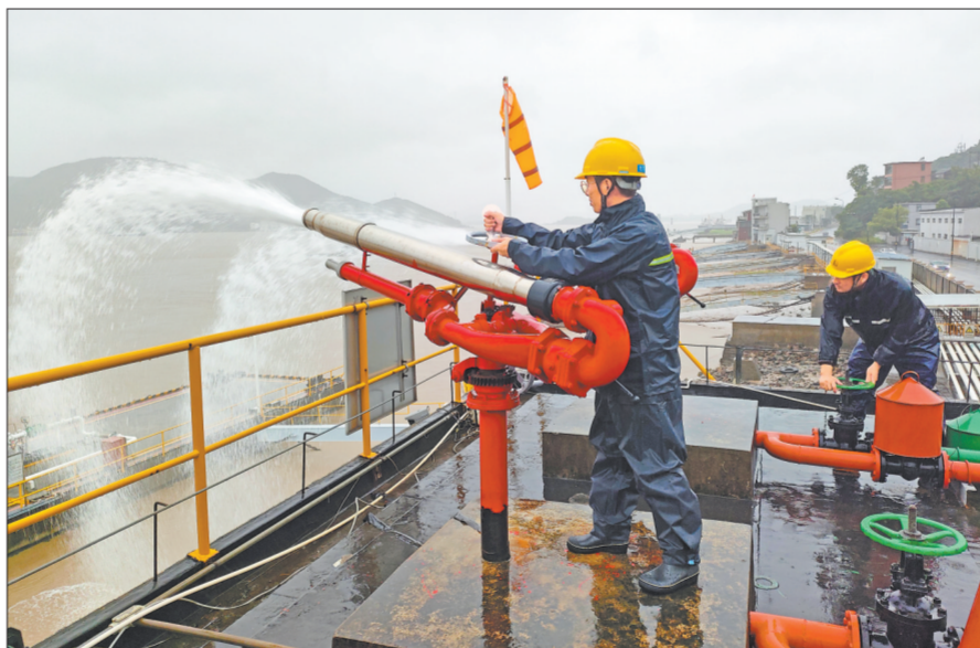
浙江石油在全省加能站储备足防汛物资,做好物品加固转移、疏通排水等工作,实行24小时值班制,动态掌握油库库存,全力保障油品供应。图为7月29日舟山港口浦油库员工开启消防管线阀门,提前排出库区消防水池积水。王林军 摄 赵志国 文
