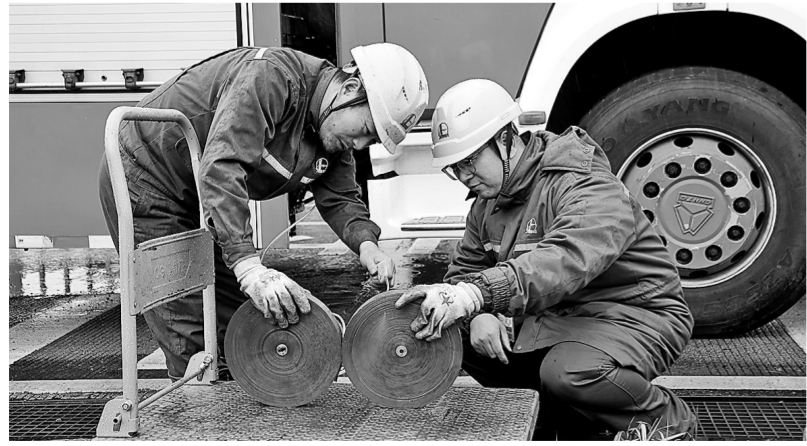
浙江石油绍兴油库员工利用消防车气刹系统的气压释放功能,代替空压机对阻火器的波纹板进行吹扫。 李嘉雯 摄
