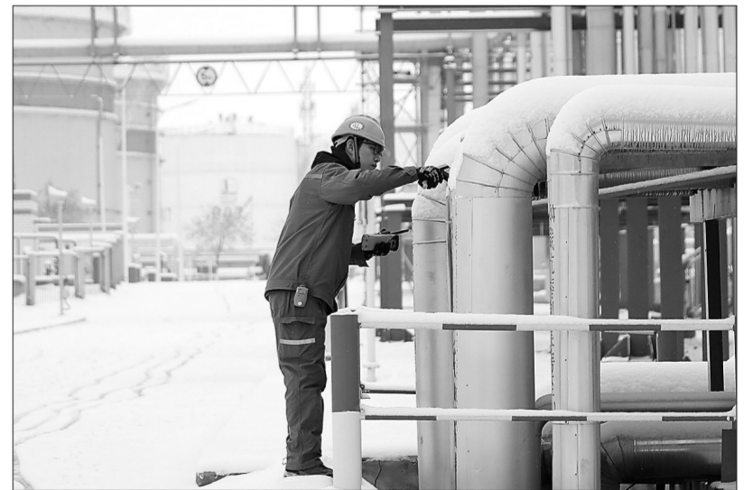
近日,新疆地区迎来降雪,塔河炼化组织开展积雪清理行动,对储罐、机泵仪表设施情况逐一检查,对管线伴热进行测温,对伴热阀门进行调整,全力保障冬季安全生产。图为班组人员对管线进行测温检查。朱军丽 摄
