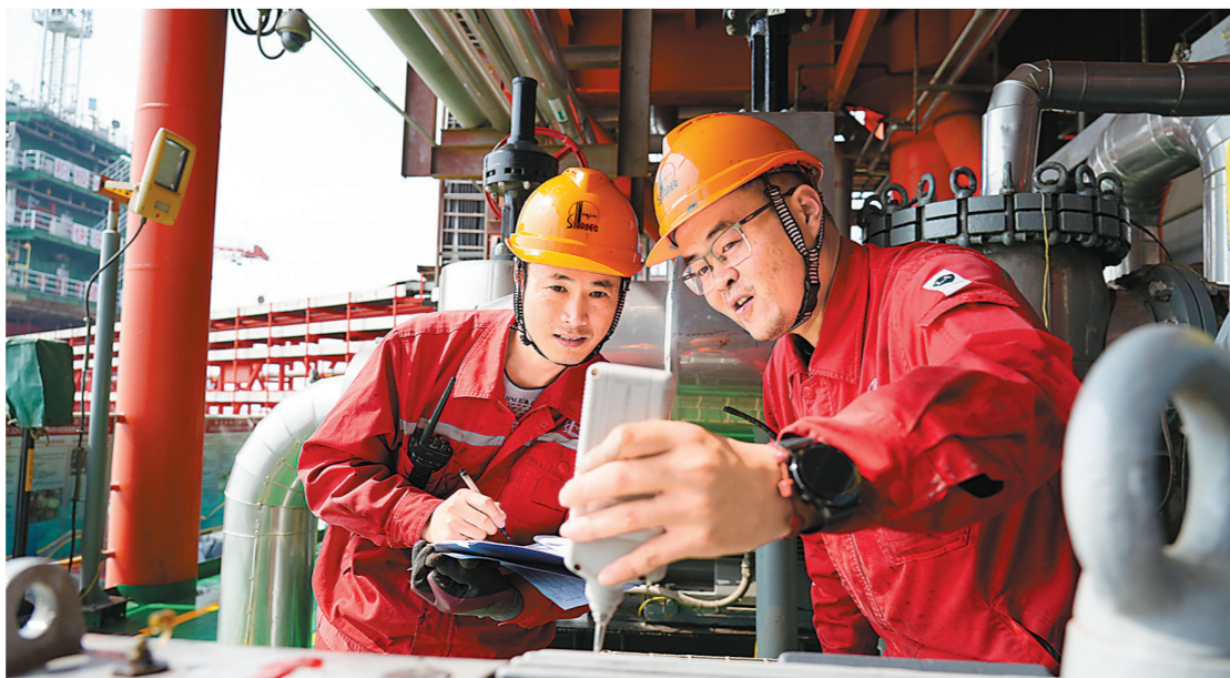
针对雨季海上高温潮湿的实际,胜利油田海洋采油厂加大设备巡检力度,全面检查设备润滑油质、连接部件运行情况,密切监控设备运行参数,严格做好维护保养工作,确保海上平台设备设施安全高效运行。图为6月17日胜利油田中心三号平台员工认真检查原油外输泵运行状态。张灿摄
