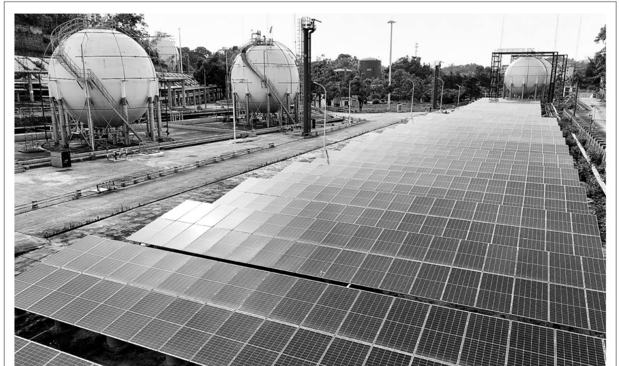
湖南石化加快光伏发电项目建设
