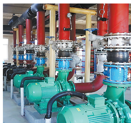
东营职业学院深层地热供暖项目设备一角。
