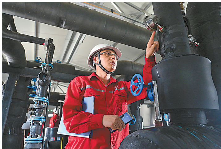
胜利油田新能源开发中心技术人员在东营公司无棣管理区办公楼检查浅层地热能项目设备。
