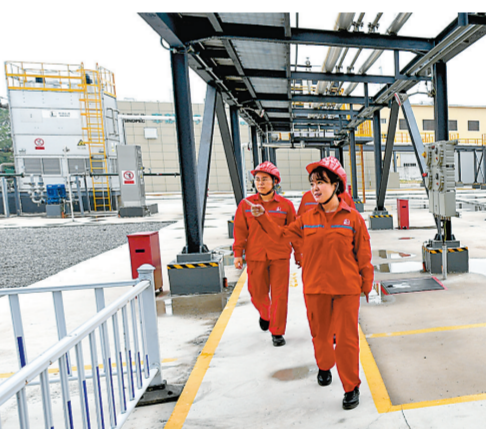
中原油田制氢车间技术人员在巡控制氢设备。赵奕松 摄
