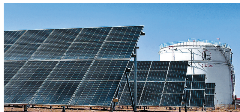
内蒙古石油临河油库分布式光伏发电项目。
