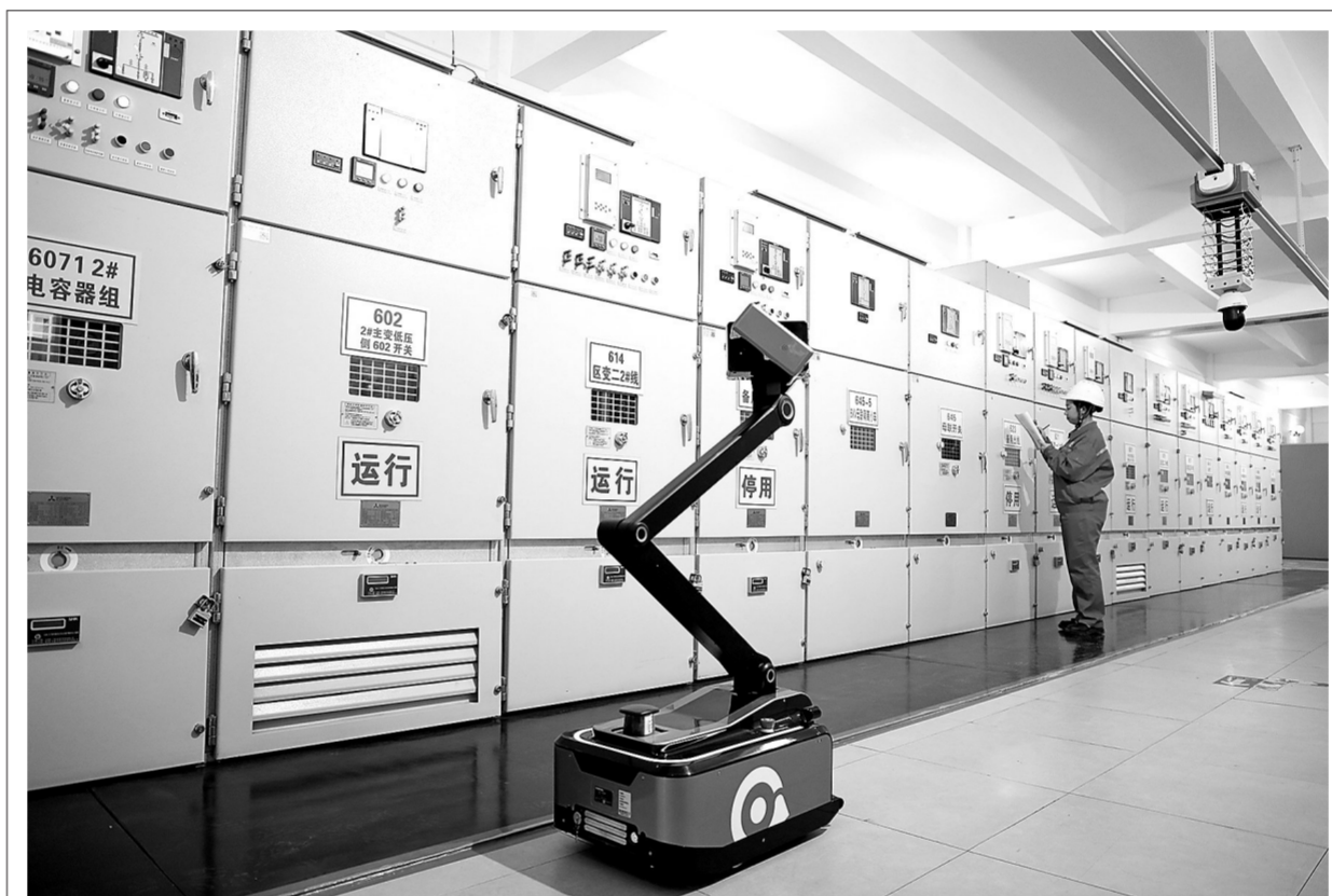
天津LNG接收站应用电力运维机器人
