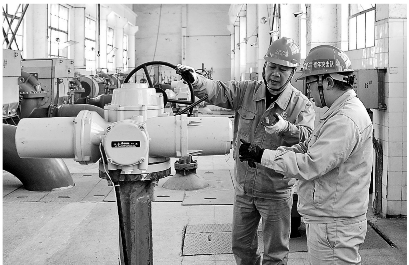
九江石化立足装置安全生产操作开展员工培训,通过现场实操、每天微课堂等多种形式,提升员工操作技能。图为3月26日,水务运行部循环水班长向班组新进员工讲述阀门操作要领。柯斌摄
