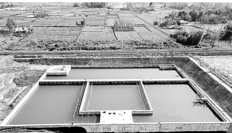
3月17日,十建公司承建的川西气田6号脱硫站最深监测池完工,项目土建施工进入收尾阶段。监测池建成后,将满足脱硫站雨水收集需求,实现水资源回收利用。图为监测池施工现场。
