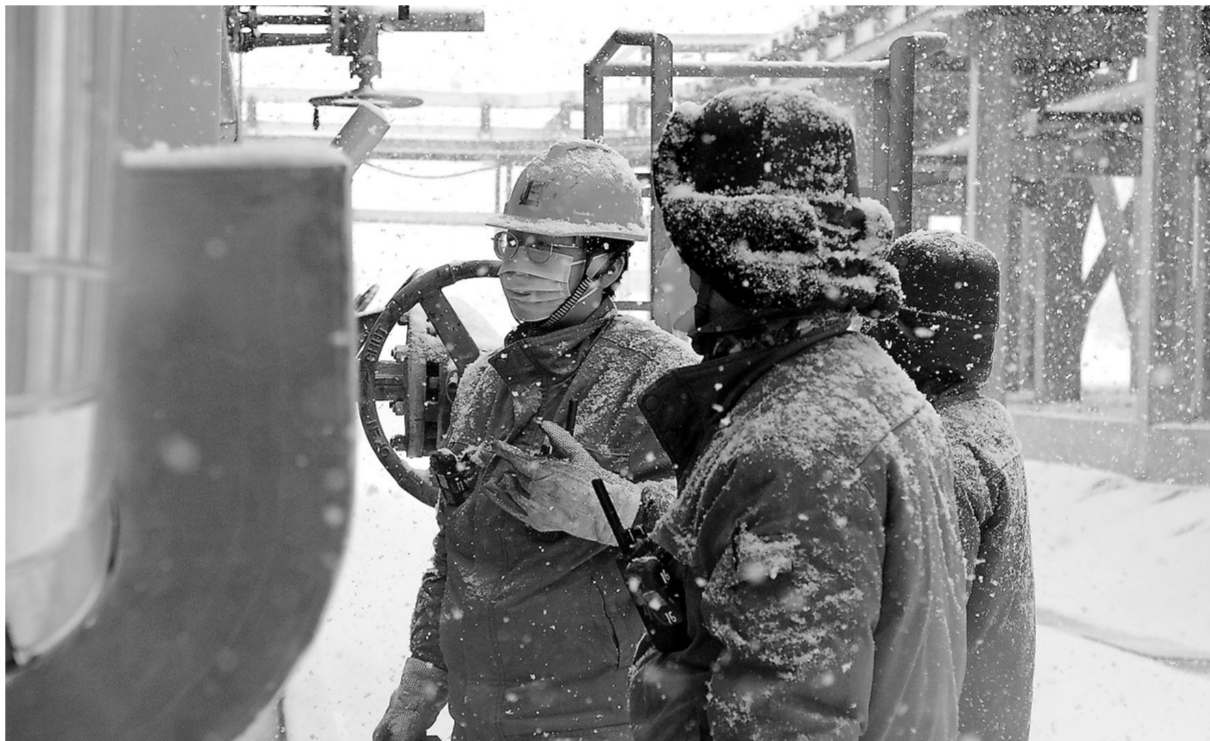
1月29日,塔河炼化2号常压焦化装置员工冒着风雪,调整电脱盐系统脱后压力。彭诗琪 摄 卢宇峰 文
