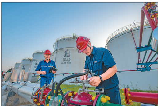
油库员工日常检查消防管线及阀门。
