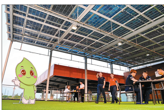
嘉泽加油站二楼露台司机之家和休闲区用电都来自光伏发电。
