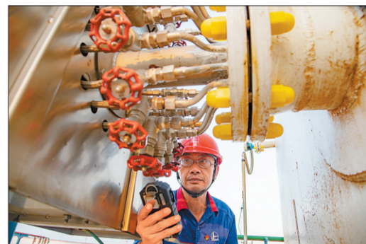
当班班长监测罐下采样器的油气浓度。
