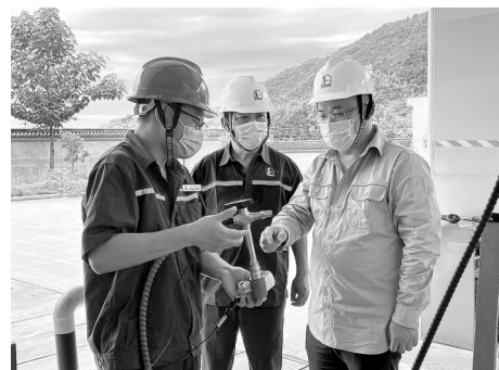
近日,浙江台州气温骤升,台州临海石油组织零管、安全等部门对8座加气站高压管线等重点部位进行安全检查,并对加压机等重点设备开展安全诊断。 蒋修飞 摄
