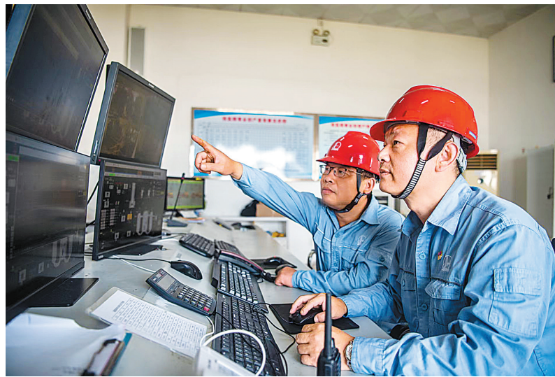
强氯精部员工正在监测“三釜”运行情况。
