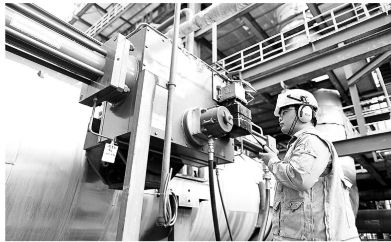
图为3号催化裂化装置外操正在检查烟机运行情况。
