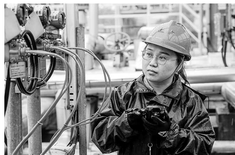
图为熊稀在乙烯成品罐区排查隐患,密切关注罐区内各仪表在雨季的运行使用情况。付松摄
