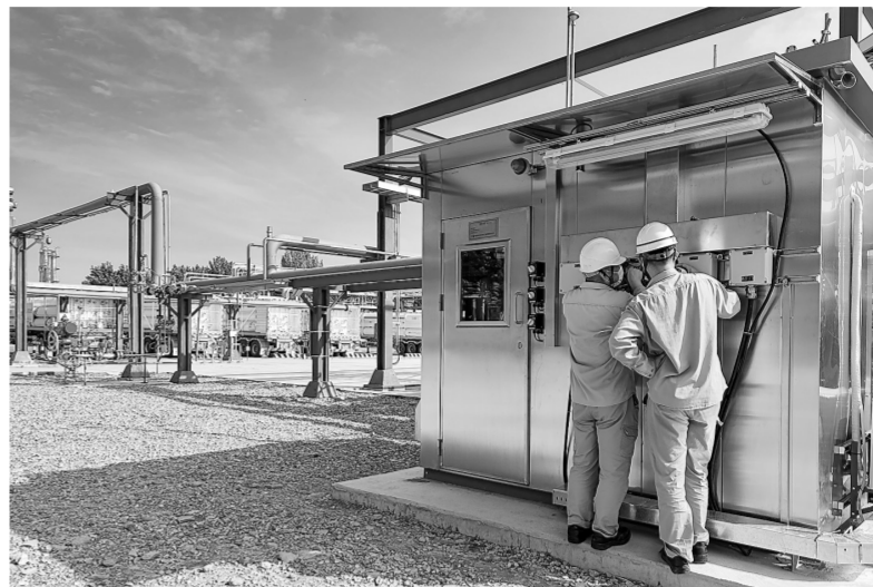
员工现场检查氢气新装置质量在线监测系统运行情况。李雪樱
